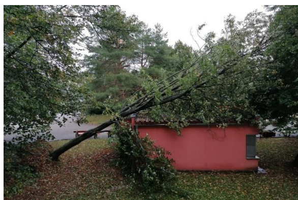
Obr. č. 56: Poškození autobusové zastávky a kolárny během zářijové vichřice, provázené povodněmi
